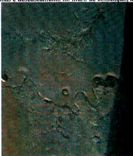
Figura 06: Bolhas e descascamento no muro de contenção, área descoberta.
