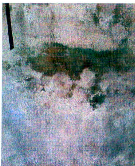
Figura 03: Manchas e bolor ocasionados pela umidade.
