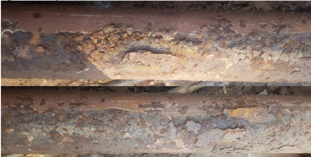
Figura 07: formação de corrosão
