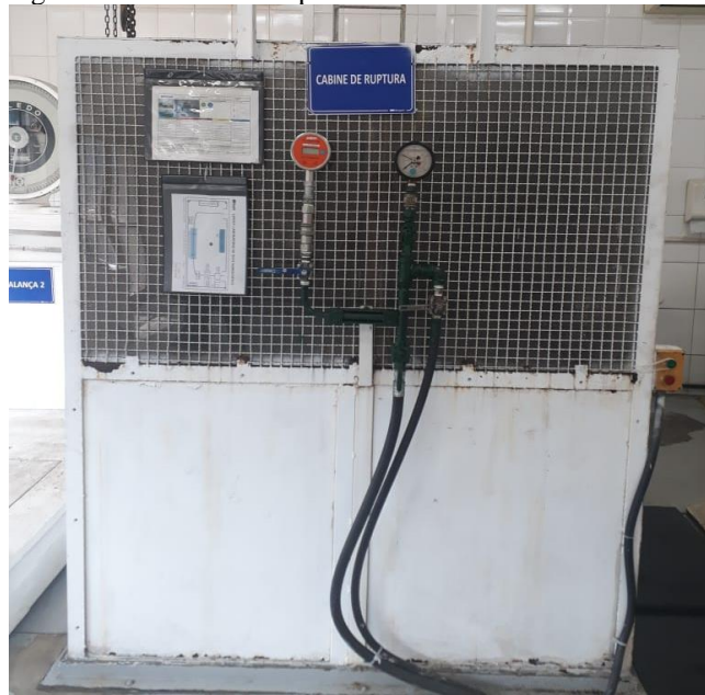
Figura 28 – Cabine de ruptura hidrostática
