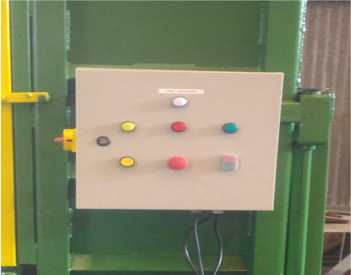
Figura 9 - Painel de comando.
