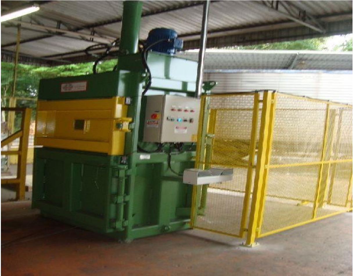
Figura 6 - Proteção de enclausuramento em prensa hidráulica.
