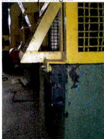
Figura 17 - Chave de segurança instalada na grade de proteção da zona de prensagem
