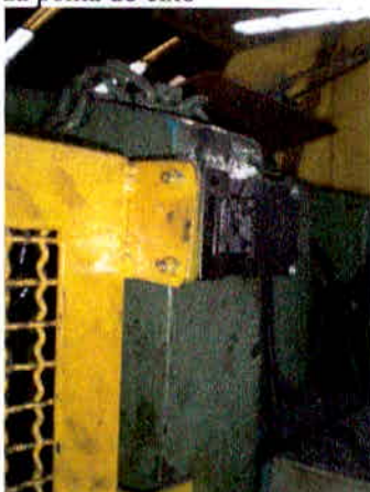
Figura 18 - Chave de segurança instalada na grade de proteção da ponta do eixo
