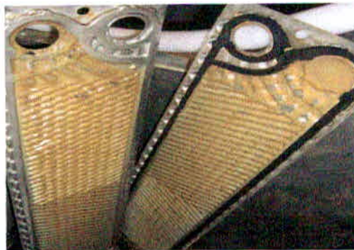
Foto 07: Incrustações nas placas. Fonte: O Autor.
