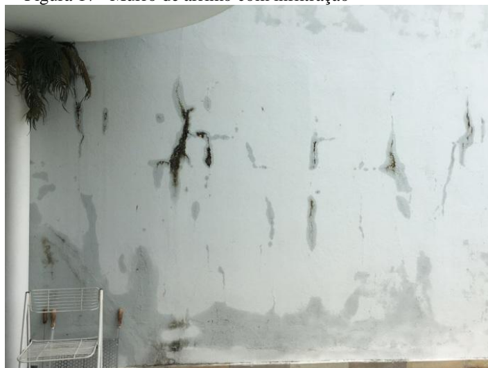
Figura 17– Murro de arrimo com infiltração
