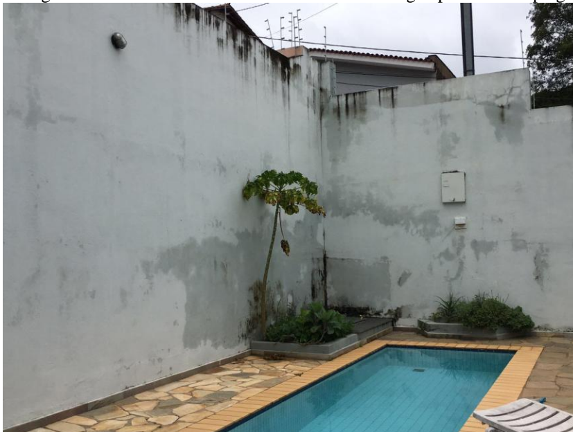
Figura 21– Murro de arrimo com escoamento da água pela falta de pingadeira
