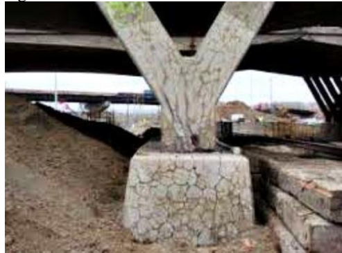
Figura 5 – RAA em estrutura de concreto
