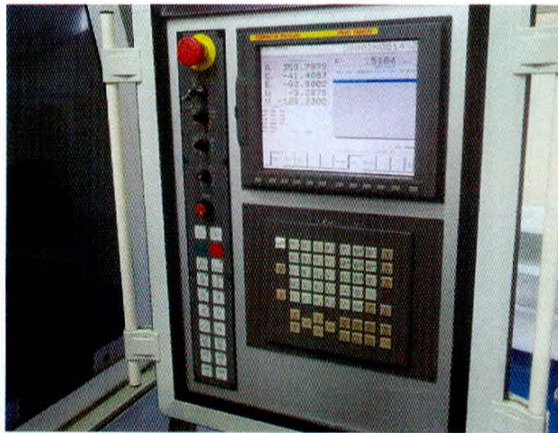
Figura 14 – Painel de Comandos Fonte: Tormep
